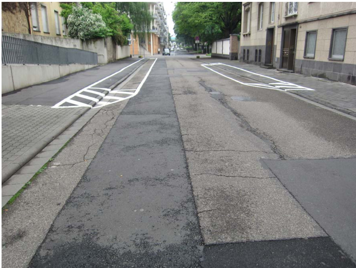
Bild Nr. 1: vorh. Fahrbahn mit Rissen und Flickstellen
