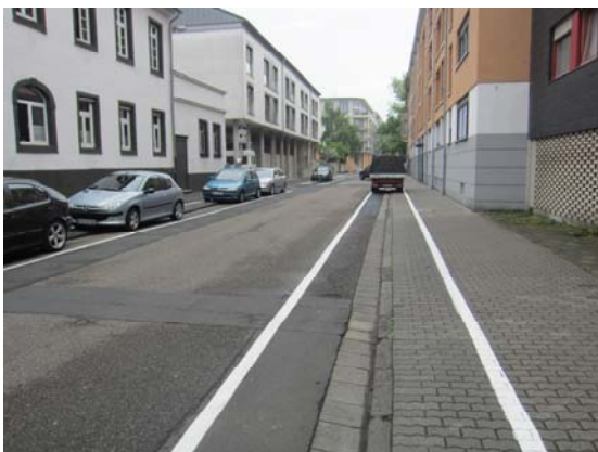
Bild Nr. 3: bituminöse Fahrbahn der Rheinstraße
