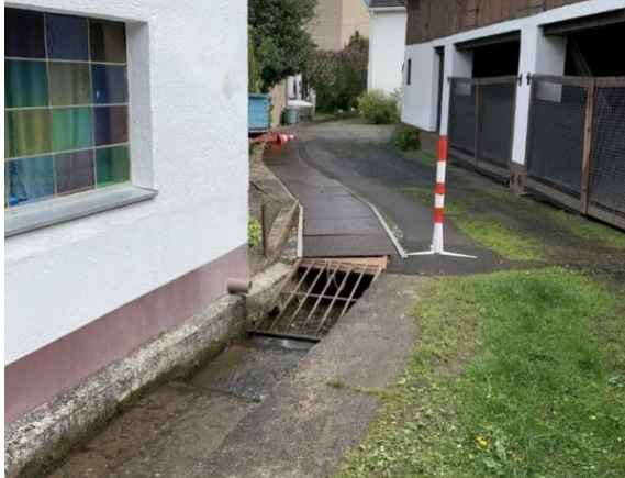
Einlaufrechen „Am Buchbach“
